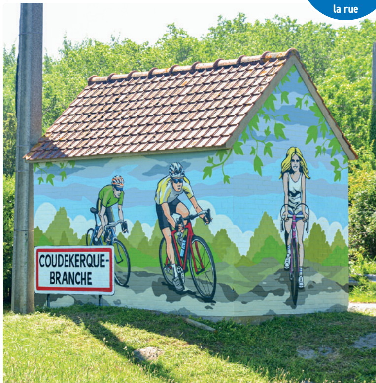
Le vélo, ce n'est pas que pour les pros ! Le transformateur électrique à l'entrée des Jardins de Steendam fait un beau clin d'œil au Tour de France.
